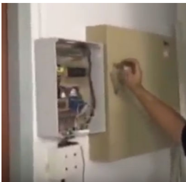
รูปที่ 11 ตำแหน่งติดตั้งชุดควบคุมระบบเปิด - ปิดหลอดไฟ
