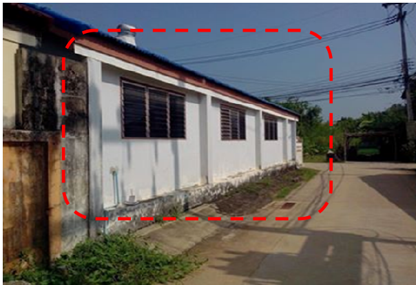
ภาพที่ 2 ไม่ขออนุญาตก่อสร้าง
