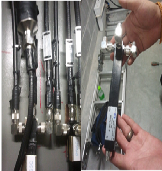
รูปที่ 12 ลักษณะการต่อ Cable feeder เข้ากับ Power Splitter
