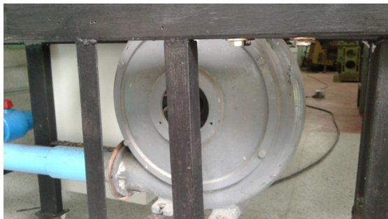
รูปที่ 2 พัดลม Blower
