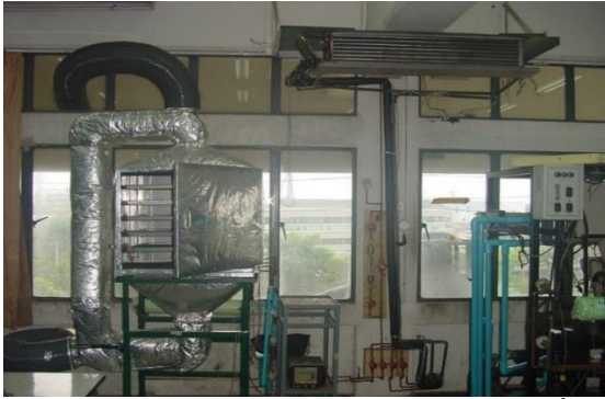
ภาพที่ 1 ระบบปรับอากาศแบบแยกส่วนที่ติดตั้งตู้อบแห้ง
